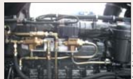
DAF tankombouw met parallel PPO leidingnet.
